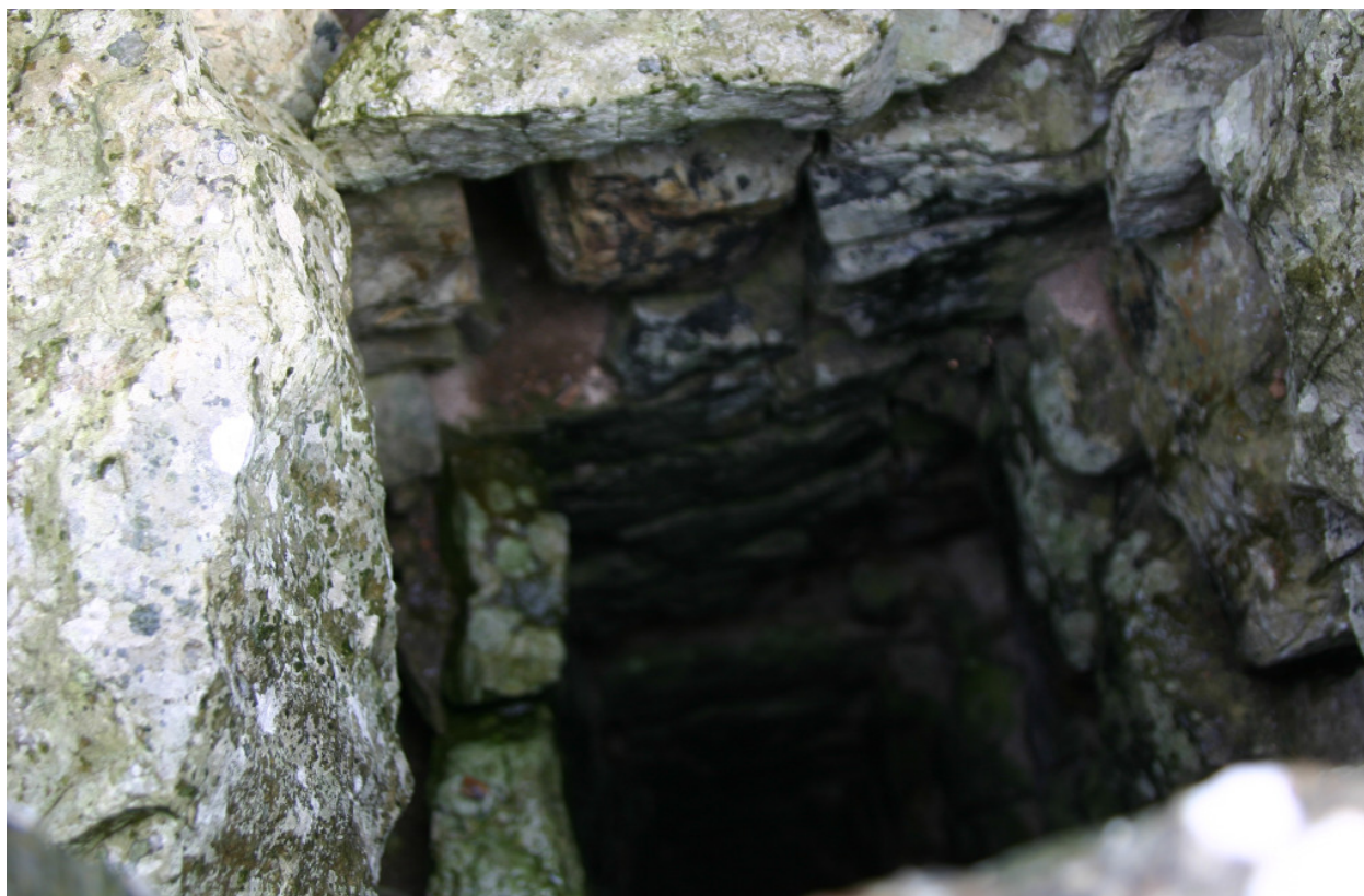
Bild av skorstenens insida tagen från toppen. Stenen i den övre delen ses ligga, i stort sett, utan bruk. Bruk som under de senaste decennierna fallit ned.
