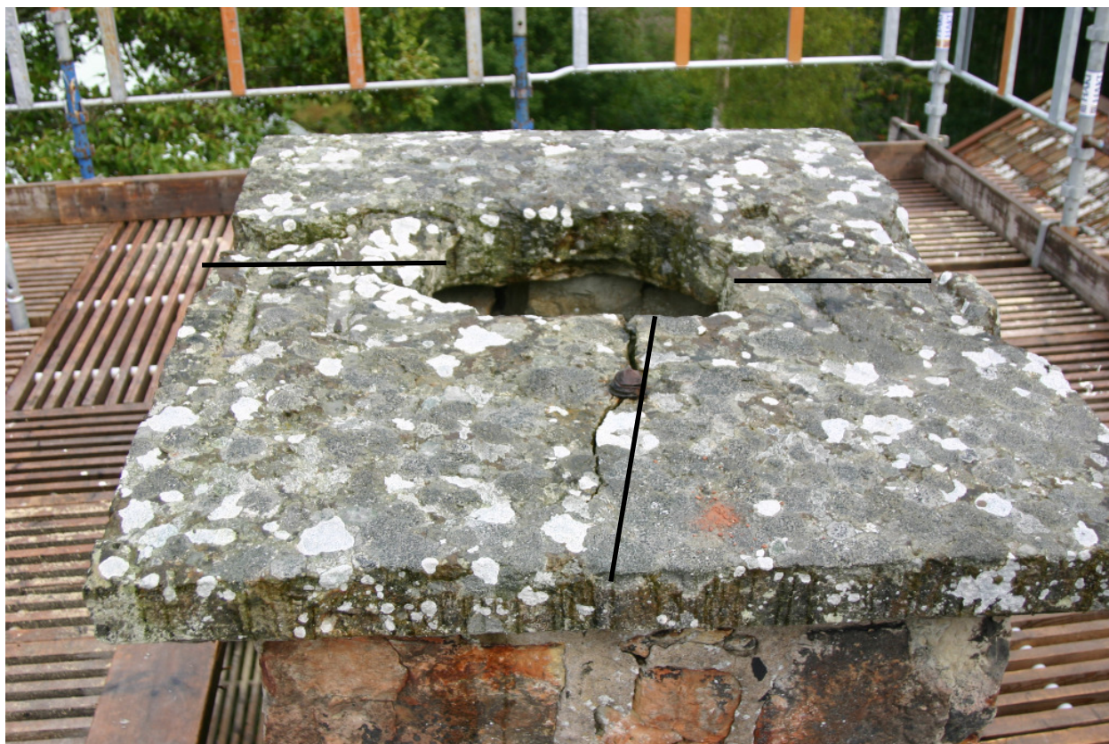
Tre svarta sträck på bilden ovan visar sprickor som topphällen hade/har.
