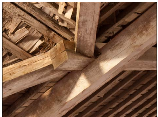
fig. 25 Foto av mötet mellan kälsparrar och takstol underifrån. Vridningen av kälsparrarna jämkar de båda takfallens lutning, så att läkten kan mötas mitt på.
