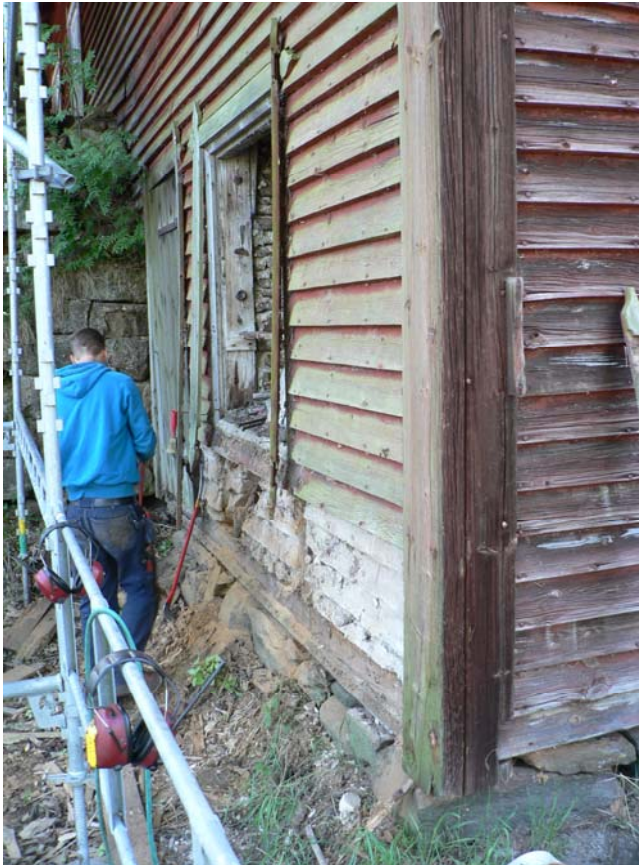
Bild 30 Röttskadad bottenstock och stolpar på den norra fasaden.
