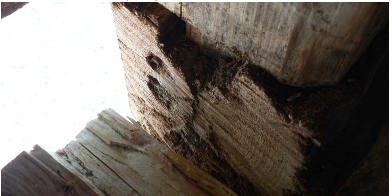
Bild 29 Rötskadad syll vid infästning av stolpe.
