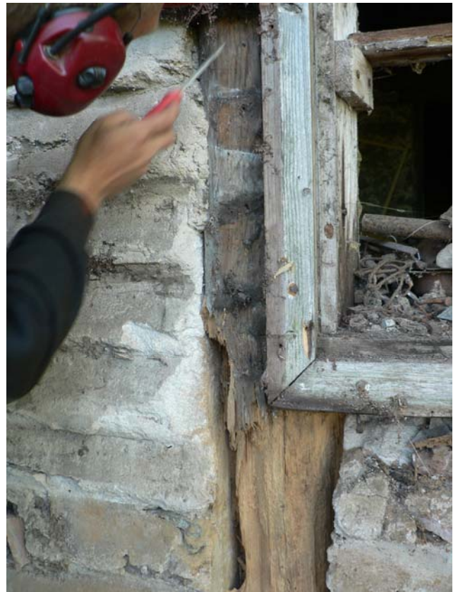
Bild 37 Några dm upp från fönstrets underkant är virket helt friskt.
