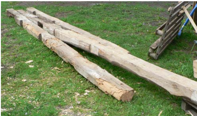
Bild 11 Rötskadade och skadedjursangripna golvstockar från sågvind
