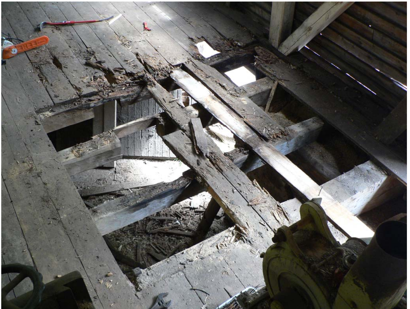
Bild 2. Friläggning av rötskadat bjälklag på sågvind.
