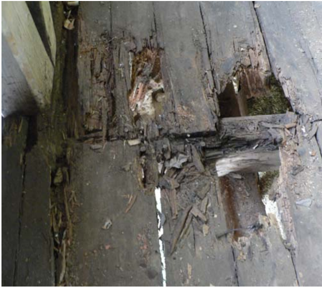
Bild 3 Detalj, rötskadat golv vid stolpe.
