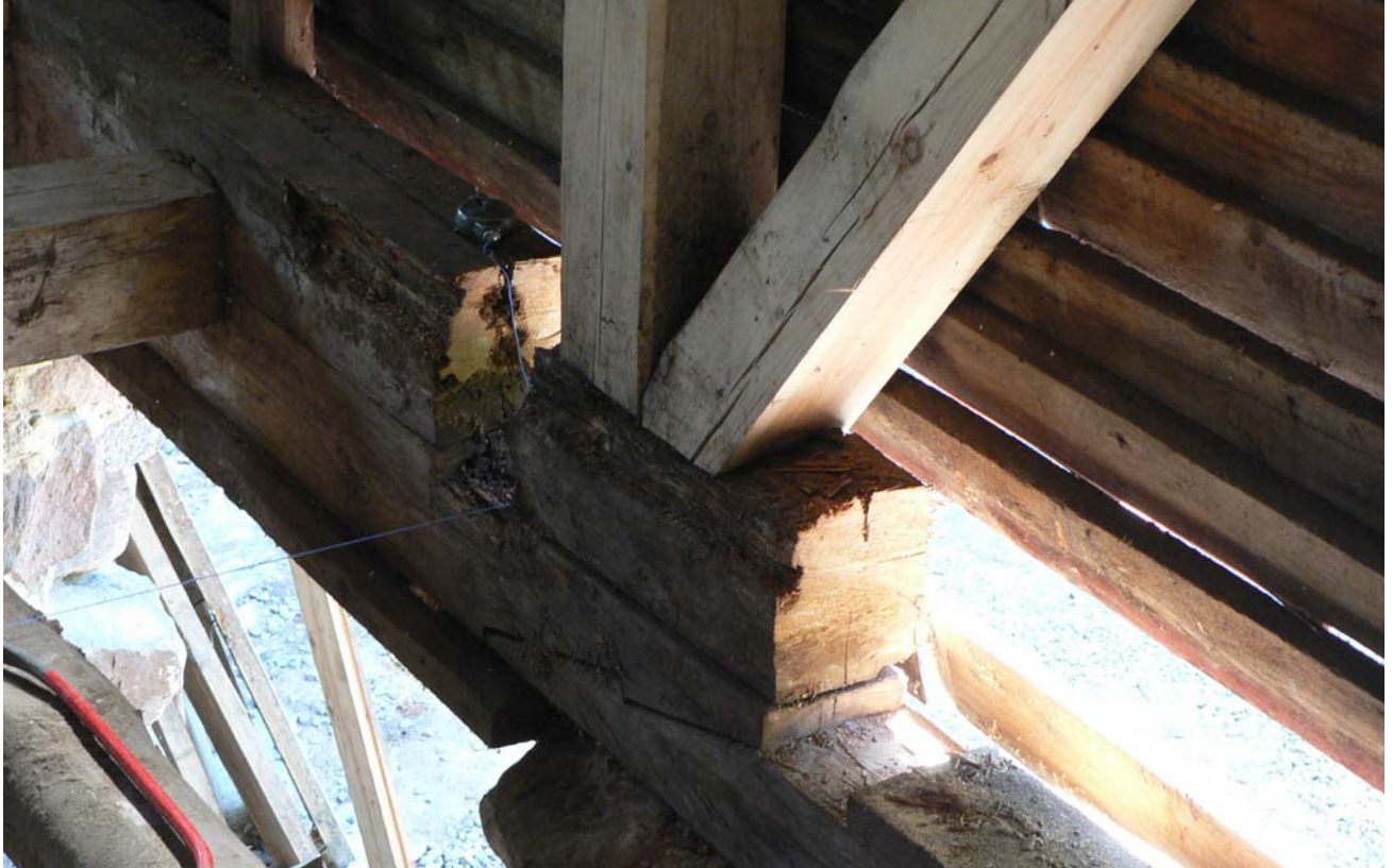
Bild 28 Rötskadad övre och undre syll på sågvind.
