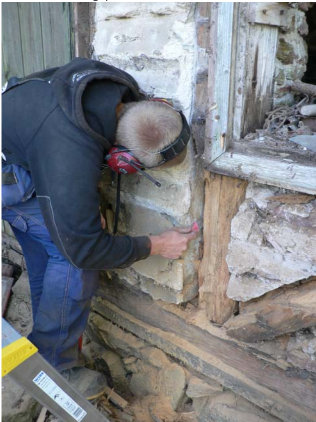
Bild 36 Kraftiga röt- och skadedjursangrepp under fönster.
