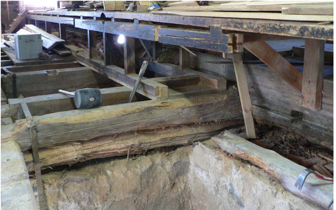
Bild 7 Mats Renström fastställer skadornas omfattning
