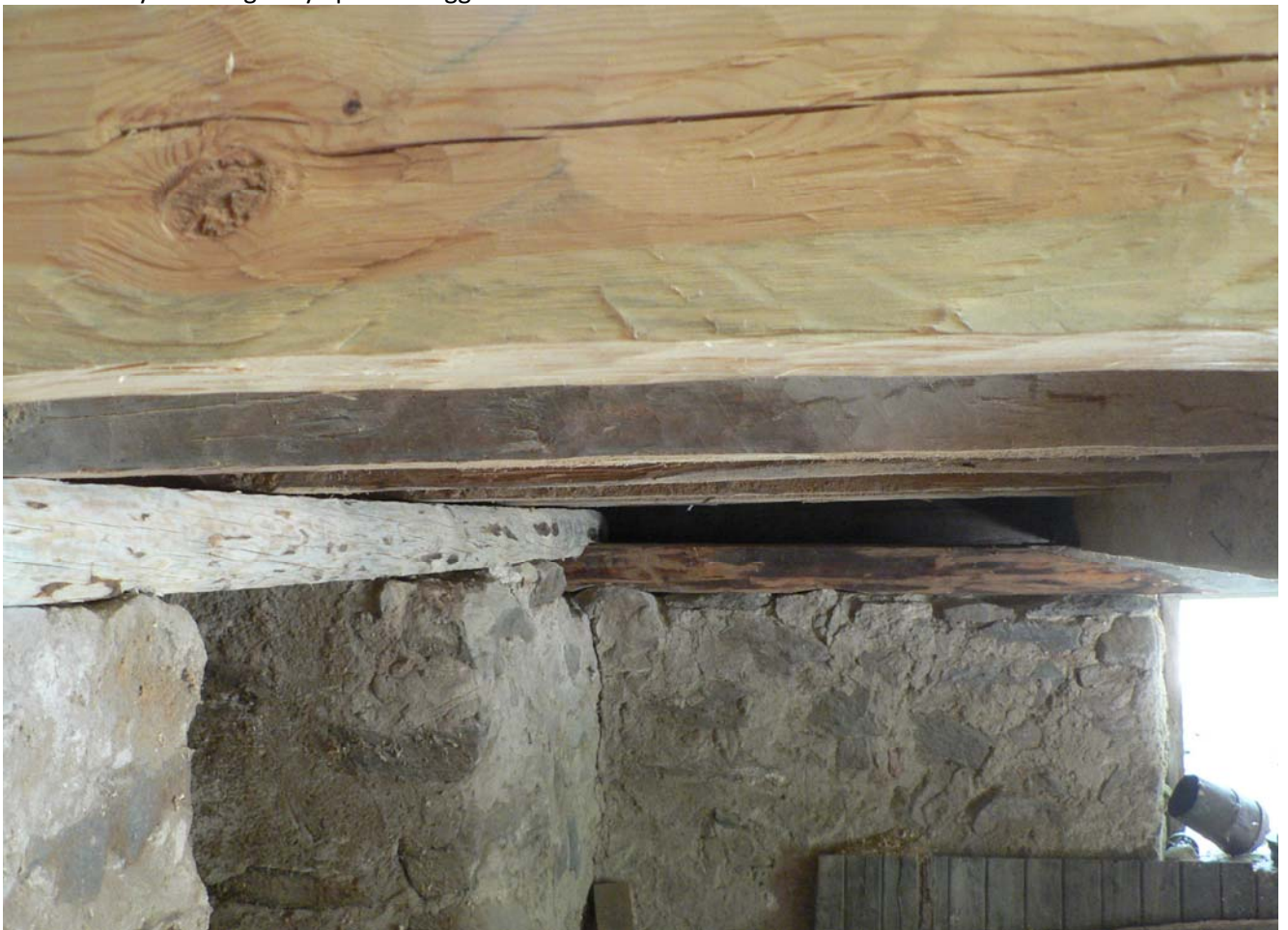
Bild 22 Utbytt syll på mittväggsmur och del av yttermur mot öster.
