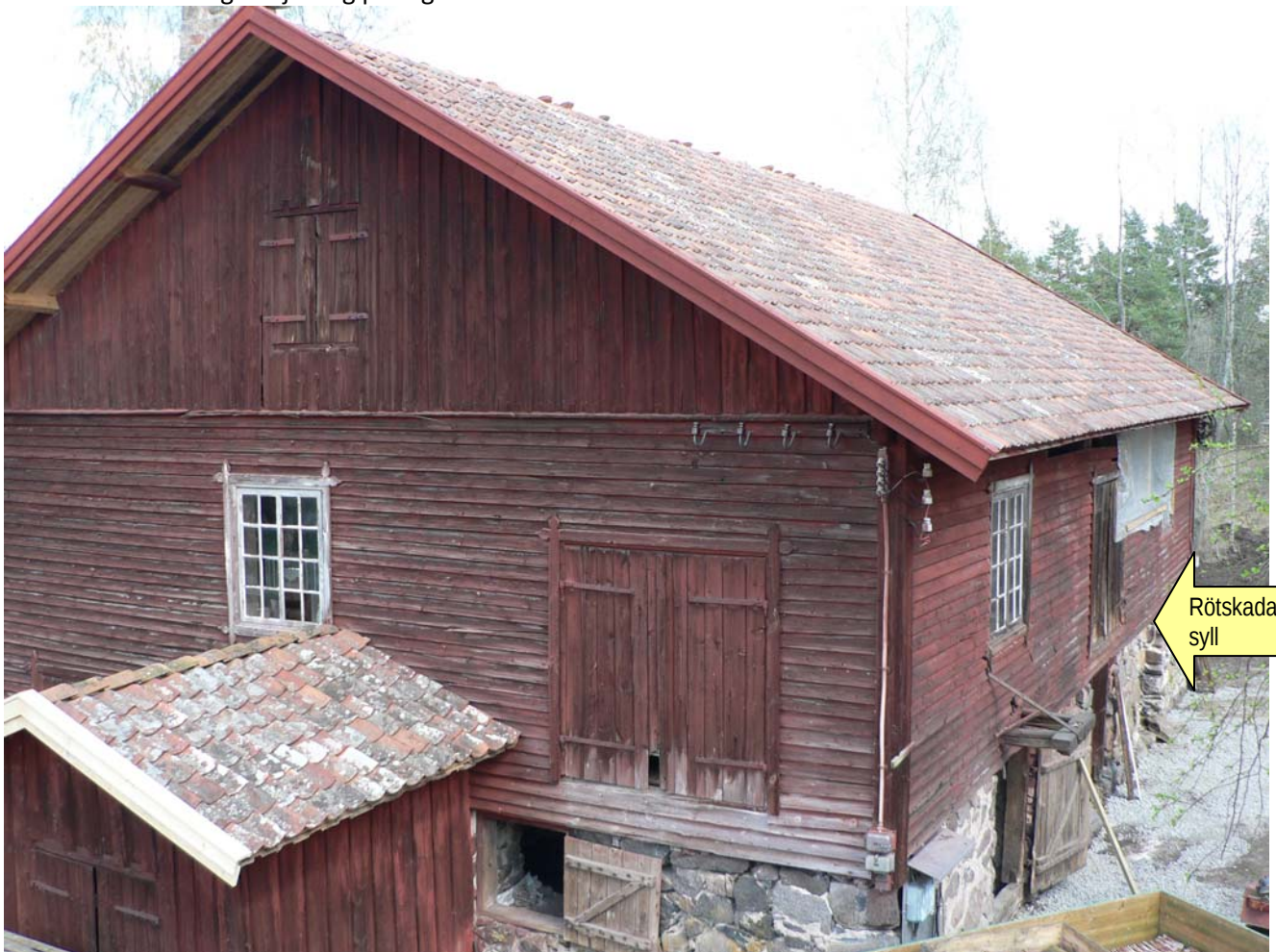
Bild 26 Ångsågen, fasad mot söder och gavel mot väster. Rötskadad syll på sågvind.
