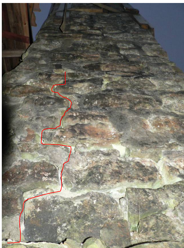
Bild 14. Spricka på östra sidan
