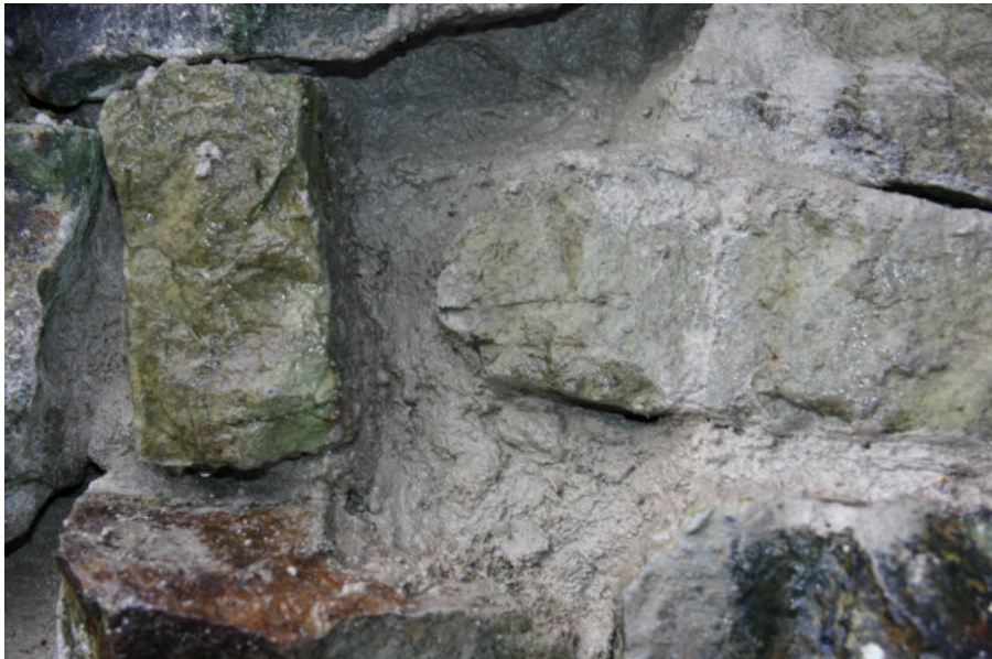
Bruket har börjat karbonatisera.
