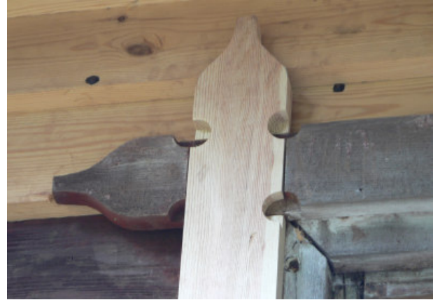
Observera felet i fodrets inre hörn. När hantverkaren skulle ta fram metod för att utföra arbetet vid återskapandet av fodren gjordes samma fel som för 140 år sedan. Se tredje bilden i bildokumentationen. Foto Erik Bergholtz.
