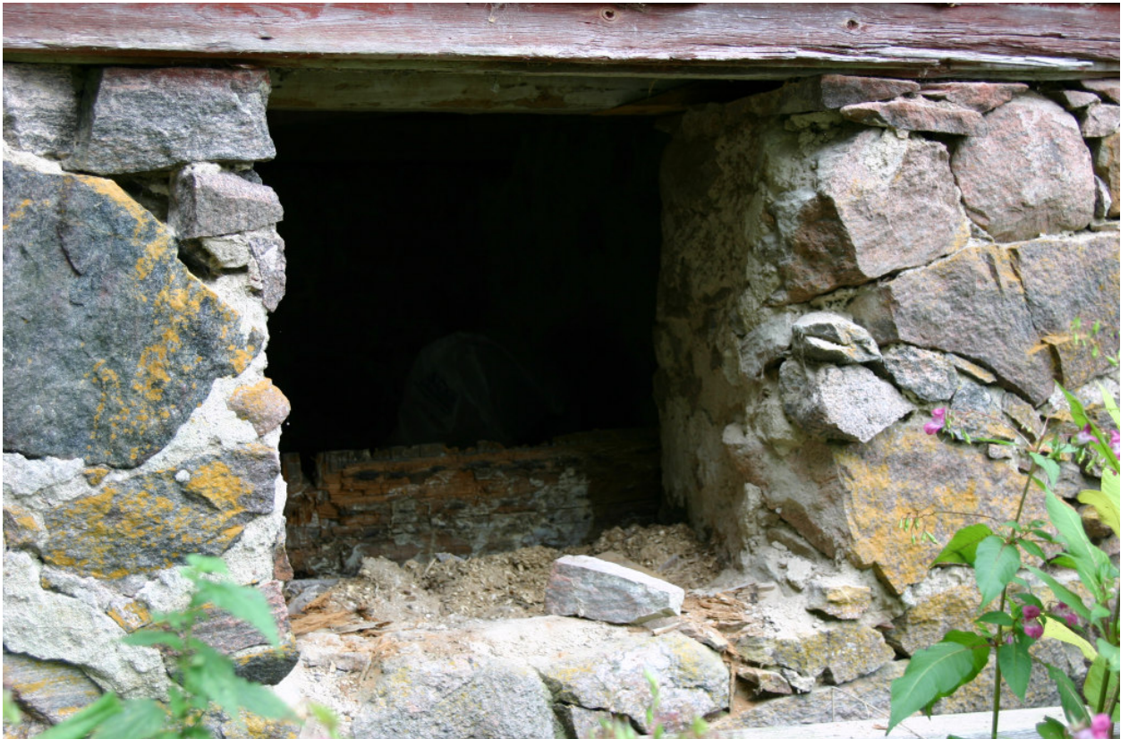
På den östra gaveln saknas luckan för öppningen i murlivet. Delar av karmträet behöver bytas ut och murlivet lagas.
