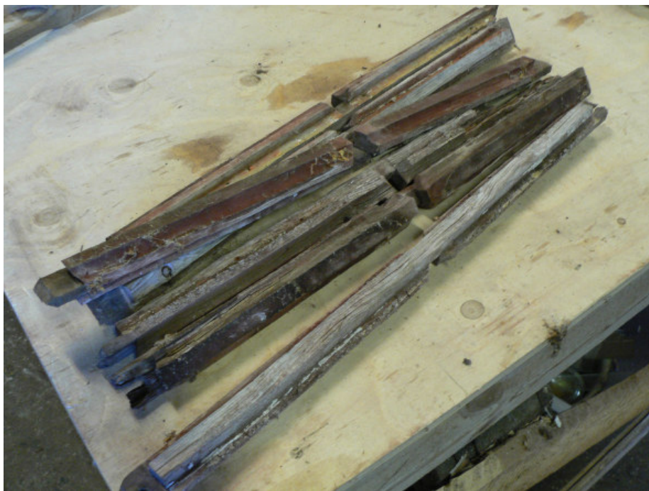
Skadade spröjs som kommer ersättas med nytillverkade. Foto Erik Bergholtz.
