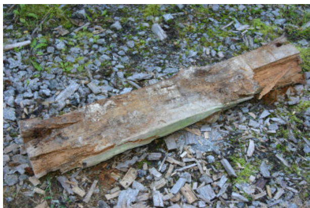
Ett rötskadat karmstycke till luckan i den östra gaveln.
