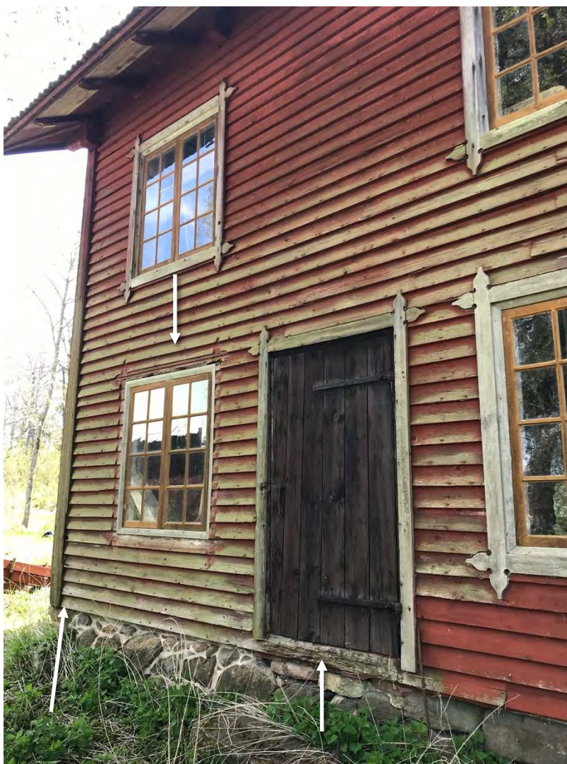
Detaljbild på skador: nedre knutbräda är rötskadad och så även delar av förvandringspanelen. De skadade paneldelarna benämns nerifrån och upp, 1 är närmast syll. 1,2,4,6 samt 18 ovan fönster är skadade och bör bytas ut. (17/5 – 22)
