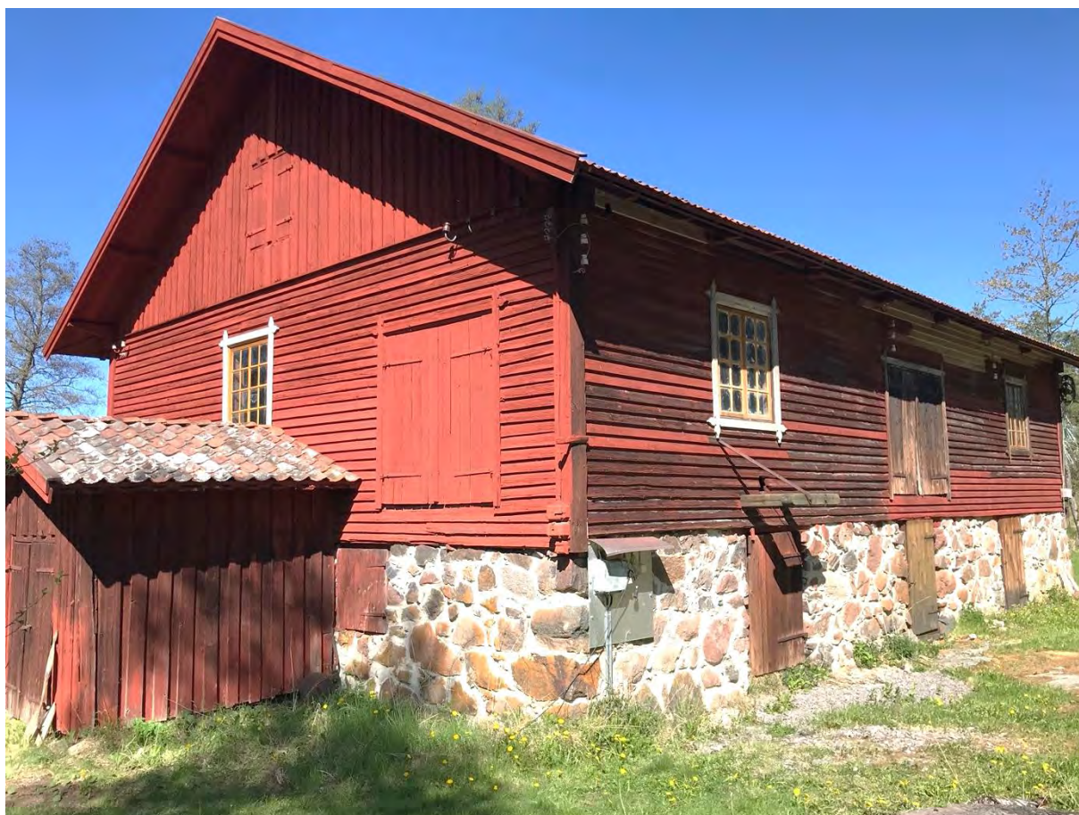
Fotografi taget över hörnet från den västra fasaden till den södra fasaden för att illustrera nyansskillnaderna mellan fasaderna. (17/5 – 22)
