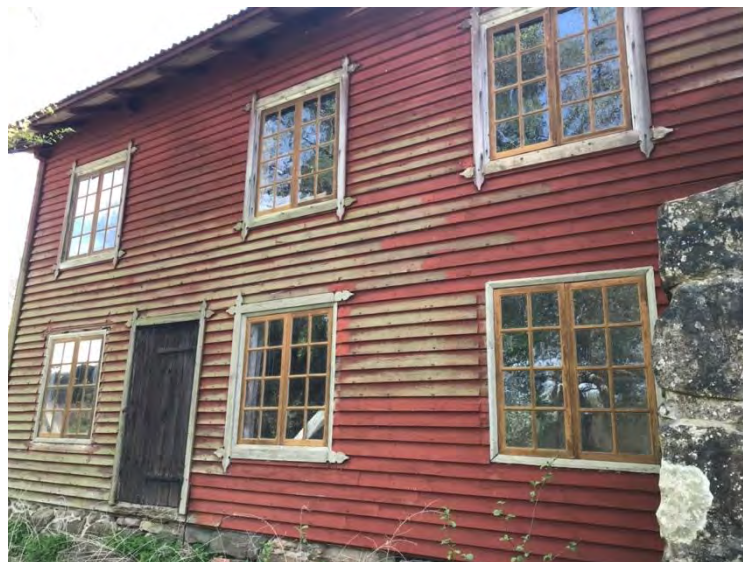
Detaljbild för att illustrera avsaknaden av fönsterfoder. (17/5 - 22)
