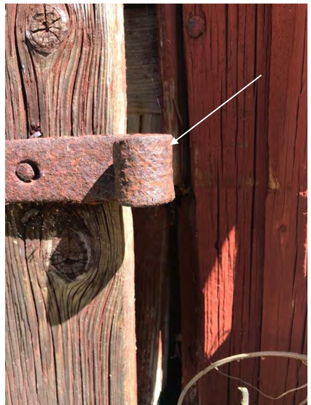
Närbild på saknaden av hakångjärn (17/5 - 22)
