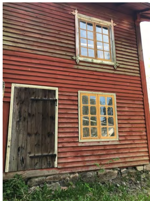
Detaljbild för att illustrera avsaknaden av fönsterfoder samt dörrfoder (17/5 - 22)
