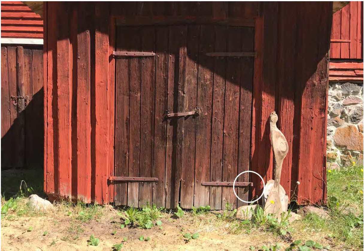
Detaljbild på sågens tillbyggnad, portens vänstra dörrblad saknar sitt nedre hakångjärn på fasaden (17/5 - 22)
